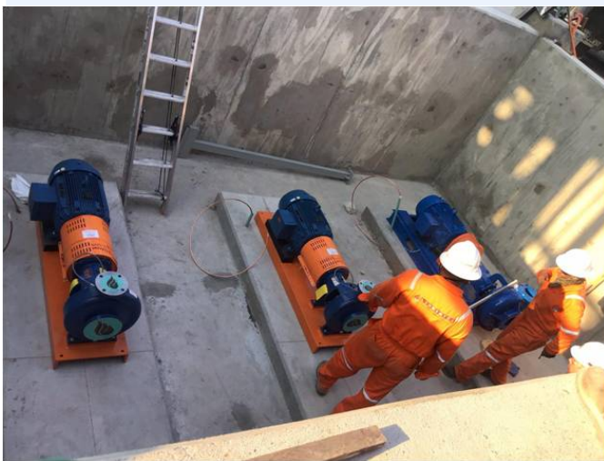
Particolare pompe sul fondo vasca
